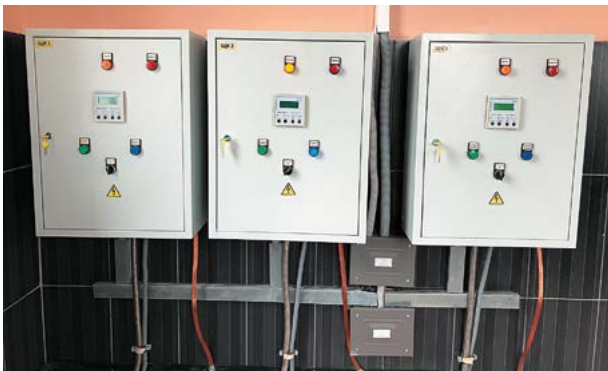
Фото 4. Шафа керування технологічним обладнанням
