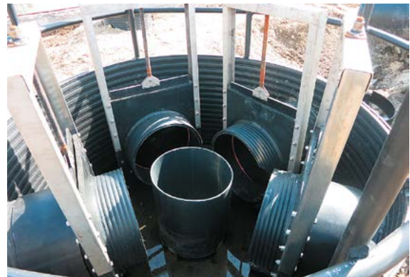
Фото 6. Приймально-розподільча камера із щитовими затворами
